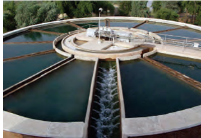
آب در تصفیه‌خانه
